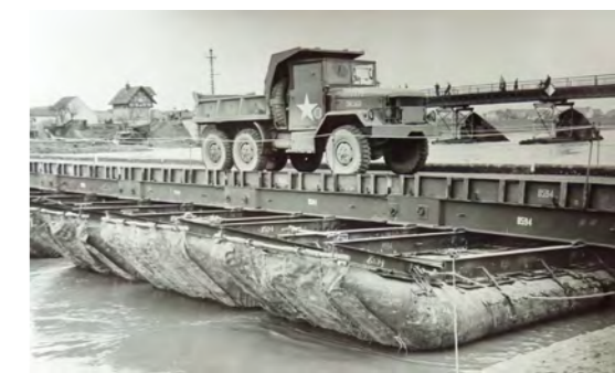
Bau einer Ponton-Brücke über den Main bei einem US-Manöver in Bergtheimfeld. Foto: Edgar Kolb/Schweinfurt
